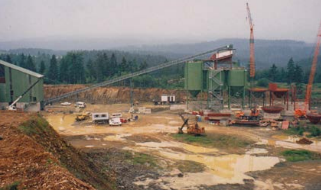
Abbildung 5: Aufbau der neuen Anlage (Stand Juni 1992).
