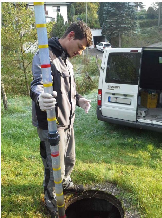
Bild 15: Schlammspiegelmessung im Rahmen der Wartung
