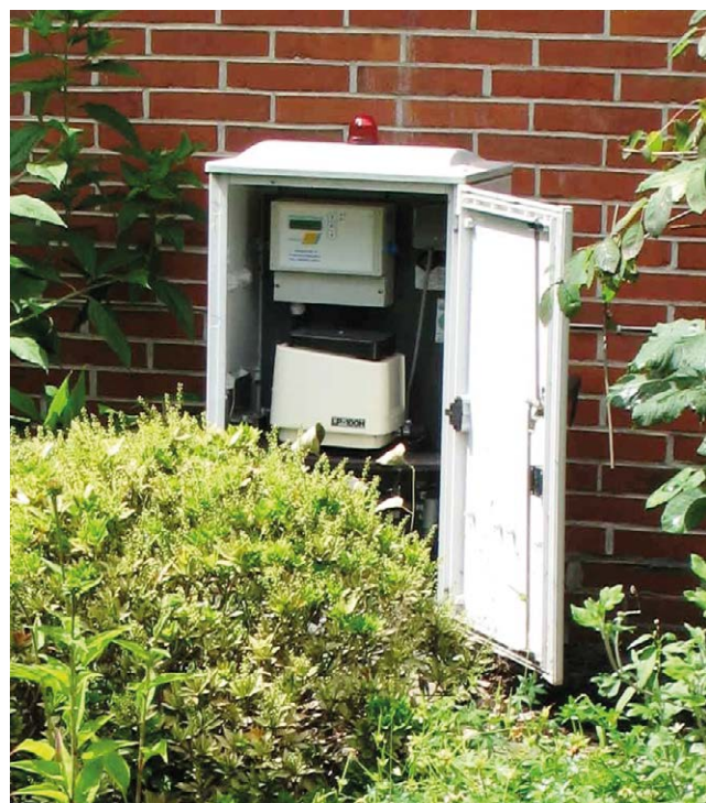
Bild 4: Schaltschrank mit Steuerungstechnik im Vorgarten
